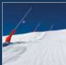
CANONS À NEIGE : alimentation en air comprimé
